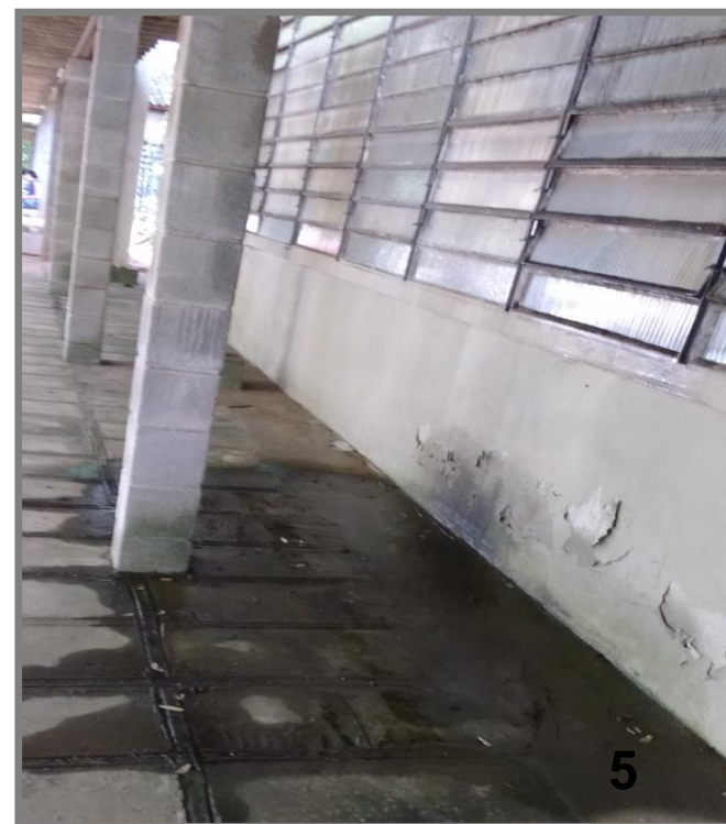
Manutenção/ área externaFEA6
